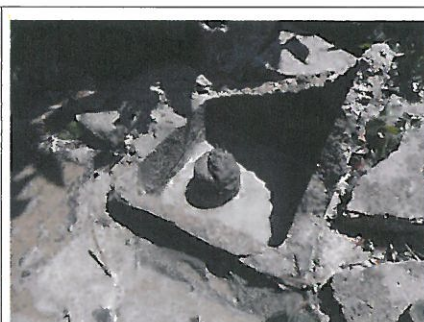
Piézomètre PzGisol rebouché
